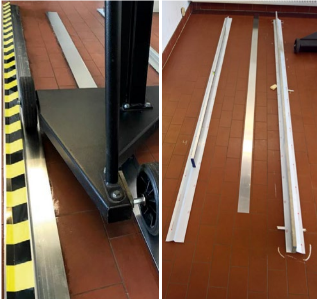
Blechstreifen abkanten oder Winkelprofil um Stabilität und einen Anschlag zu bekommen. Die Profile auf dem Hallenboden ausrichten und montieren (kleben oder schrauben). (Materialkosten ca. 200 €)
